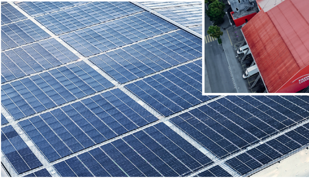
Die neu realisierte Photovoltaikanlage beim Eiszentrum.
