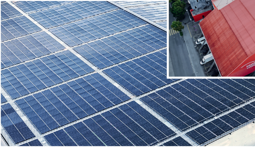
Die neu realisierte Photovoltaikanlage beim Eiszentrum.
